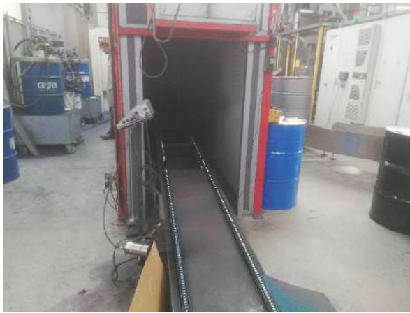
Tunnel de séchage et stockage de fûts de peinture (PC4)
