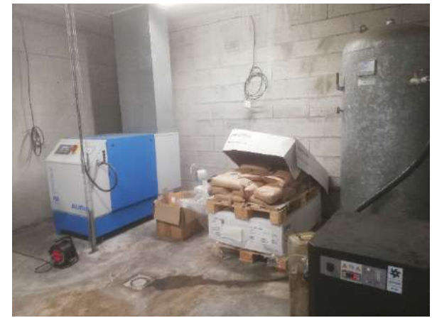
Local compresseur (CA1)
