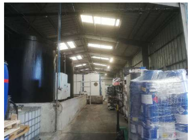
Traitement des eaux (PC2) - Stockage des emballages non conformes (DEC3) - Cuves de stockage des eaux sales à traiter (DEC6) - Stockage des huiles de récupération (DEC7)
