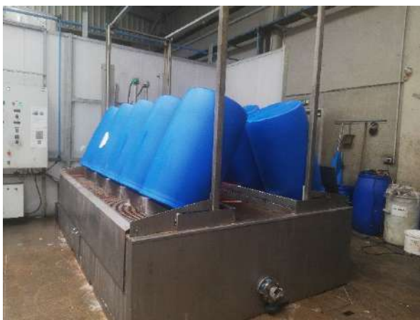
Zone de lavage intérieur atelier plastique (LAV2)
