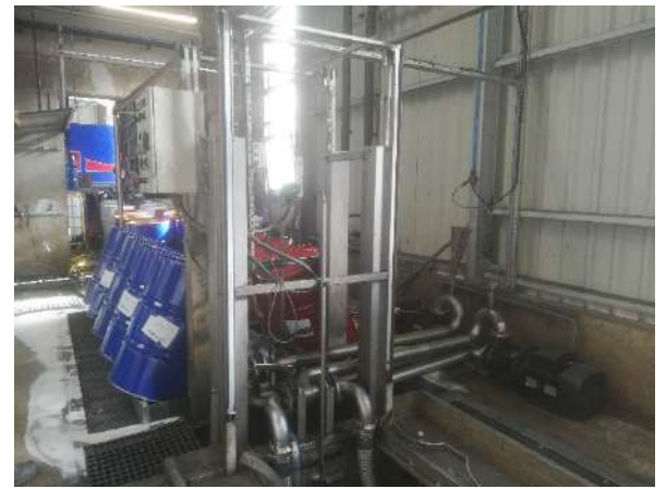
Zone de lavage atelier métallique (LAV1)
